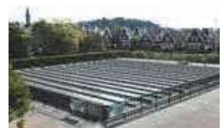
太陽光発電システム
